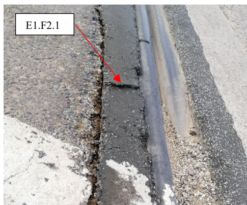
Figura 4.25: Ilustración de falla E1.F2.1. Fuente: Propia, puente Petorca, 2021.
