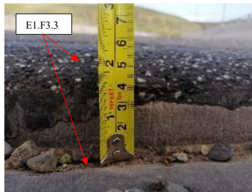
Figura 4.29: Ilustración de falla E1.F3.3. Fuente: Propia, puente Petorca, 2021.
