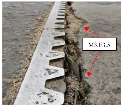
Figura 4.21: Ilustración de falla M3.F3.5. Fuente: Propia, puente San Pedro, 2021.
