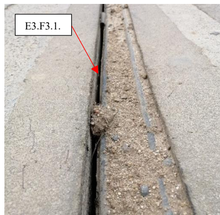
Figura 4.39: Ilustración de fallas E3.F3.1 Fuente: Propia, puente Lo Gamboa, 2021.
