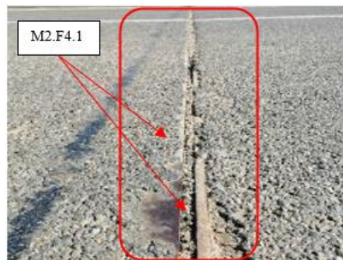
Figura 4.7: Ilustración de falla M2.F4.1. Fuente: Propia, puente Lo Abarca, 2021.
