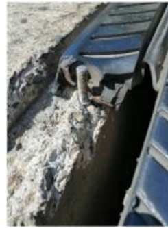
Figura 132 Pérdida de apriete en tuercas, ausencia de fijación
