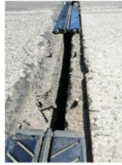
Figura 131 Desprendimiento del dispositivo (parcial o total)
