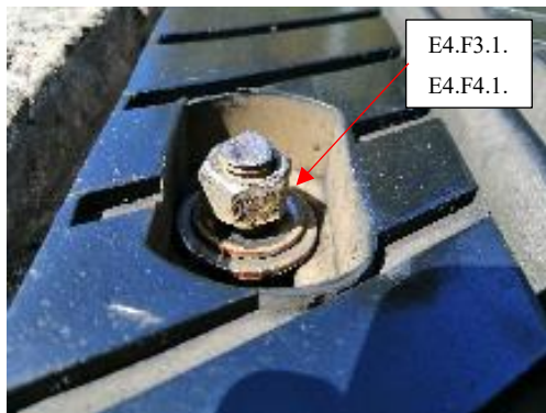
Figura 4.48: Ilustración de falla E4.F3.1 y E4.F4.1 Fuente: Propia, puente Marga Marga, 2021.
