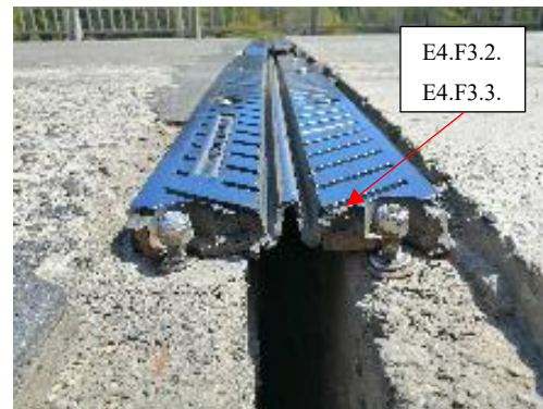
Figura 4.49: Ilustración de falla E4.F3.2 y E4.F3.3 Fuente: Propia, puente Marga Marga, 2021.
