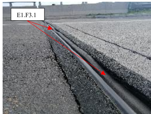
Figura 4.27: Ilustración de falla E1.F3.1. Fuente: Propia, puente Petorca, 2021.
