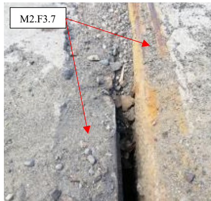
Figura 4.14: Ilustración de fallas M2.F3.7 Fuente: Propia, puente Río Blanco 1, 2021.
