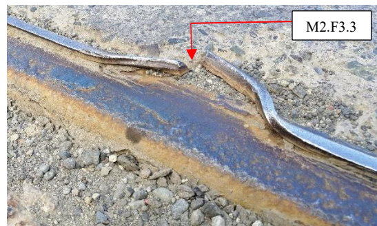
Figura 4.13: Ilustración de fallas M2.F3.3 Fuente: Propia, puente Río Blanco 1, 2021.
