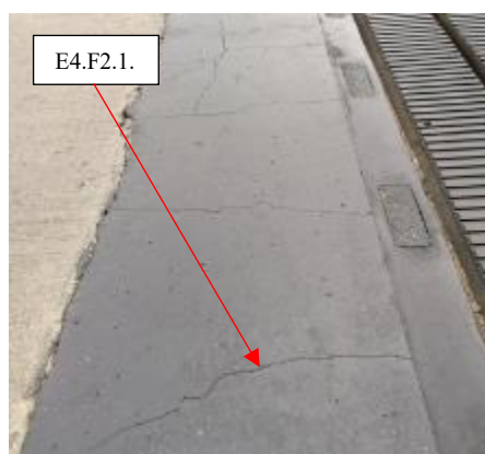
Figura 4.46: Ilustración de falla E4.F2.1 Fuente: Propia, puente Pelumpen, 2021.
