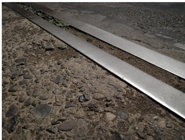
Figura 3.5: Cantonera de guarda canto en puente Los Olmos. Fuente: Propia del autor en inspecciones realizadas, 2021.
