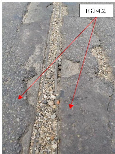
Figura 4.44: Ilustración de falla E3.F4.2 Fuente: Propia, puente Santa Julia, 2021.
