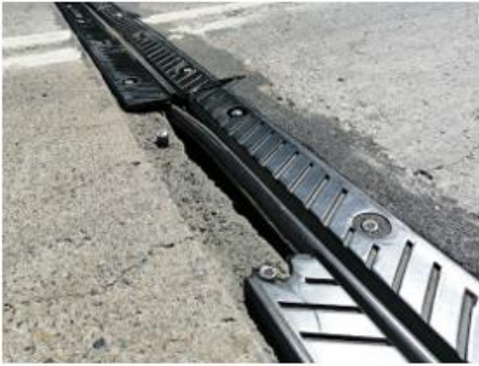
Figura 129 Daños en los cantos del tablero, desmoronamiento o pérdida de hormigón
