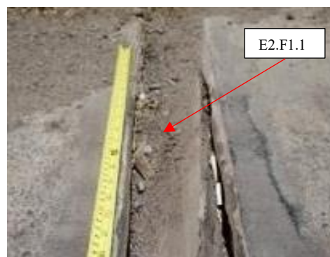
Figura 4.30: Ilustración de falla E2.F1.1. Fuente: Propia, puente 21 de mayo, 2021.
