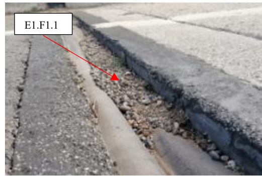
Figura 4.24: Ilustración de falla E1.F1.1. Fuente: Propia, puente Petorca, 2021.
