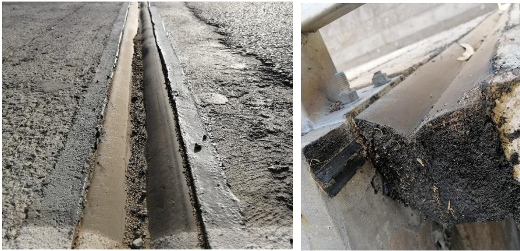
Figura 3.16: Cantonera de EPDM inflable en puente Illalolén. Fuente: Propia del autor en inspecciones realizadas, 2021.
