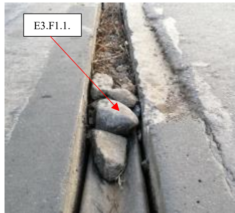
Figura 4.36: Ilustración de fallas E3.F1.1 Fuente: Propia, puente Senador Alfredo Jaraquemada, 2021.
