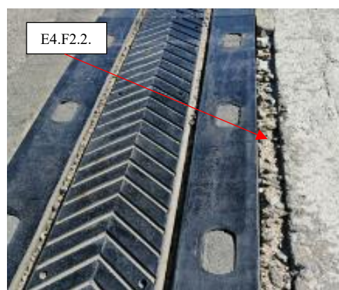
Figura 4.47: Ilustración de falla E4.F2.2 Fuente: Propia, puente Lo Orozco, 2021.
