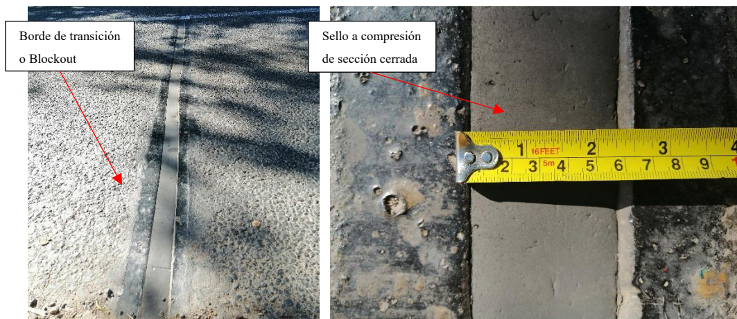
Figura 3.14: sello a compresión sección cerrada en puente Chagres. Fuente: Propia del autor en inspecciones realizadas, 2021.
