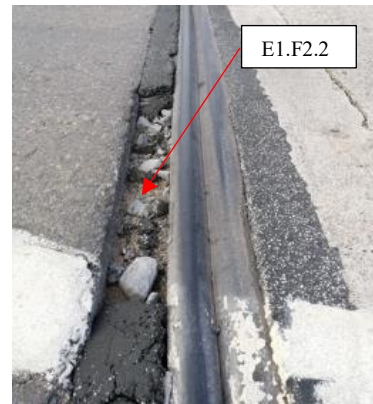
Figura 4.26: Ilustración de falla E1.F2.2. Fuente: Propia, puente Petorca, 2021.
