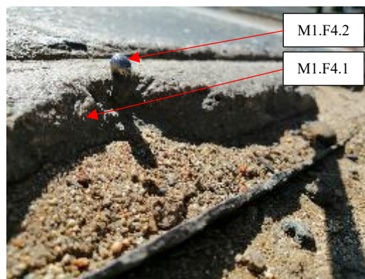
Figura 4.5: Ilustración de fallas M1.F4.1. y M1.F4.2. Fuente: Propia, puente San Gerónimo, 2021.
