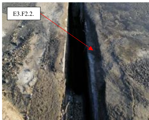
Figura 4.37: Ilustración de fallas E3.F2.2 Fuente: Propia, puente La Higuera, 2021.
