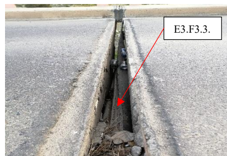
Figura 4.41: Ilustración de fallas E3.F3.3 Fuente: Propia, puente Senador Alfredo Jaraquemada, 2021.
