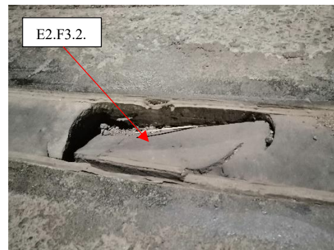
Figura 4.34: Ilustración de falla E2.F3.2. Fuente: Propia, puente 21 de mayo, 2021.
