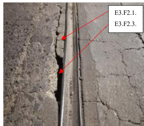
Figura 4.38: Ilustración de fallas E3.F2.1. Fuente: Propia, puente Putaendo, 2021.
