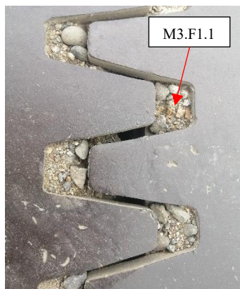
Figura 4.15: Ilustración de falla M3.F1.1 Fuente: Propia, puente San Pedro, 2021.
