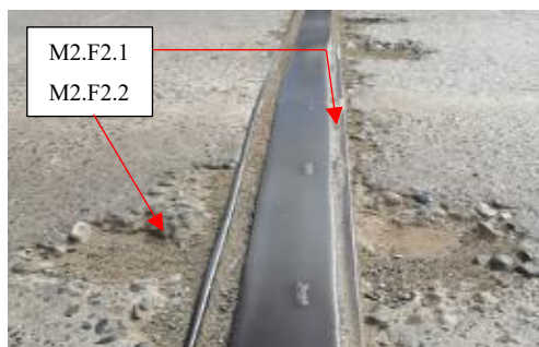
Figura 4.8: Ilustración de falla M2.F2.1 y M2.F2.2. Fuente: Propia, puente Pasarela La Laguna, 2021.
