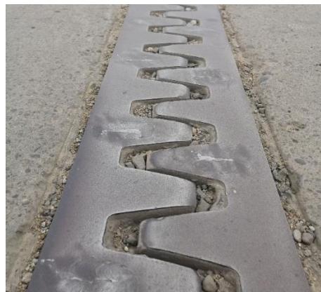
Figura 3.9: Cantonera de placa dentada en puente Colmo. Fuente: Propia del autor en inspecciones realizadas, 2021.
