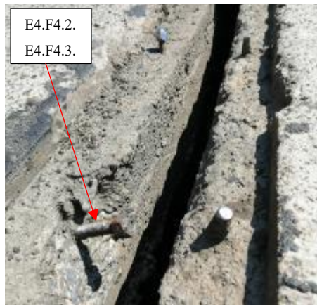
Figura 4.50: Ilustración de falla E4.F4.2 y E4.F4.3 Fuente: Propia, puente Marga Marga, 2021.
