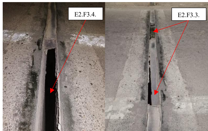
Figura 4.35: Ilustración de falla E2.F3.3. y E2.F3.4.
