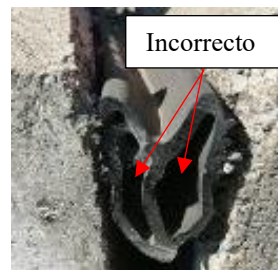
Figura 4.43: Ilustración de falla E3.F4.1 Fuente: Propia, puente Carretón, 2021.
