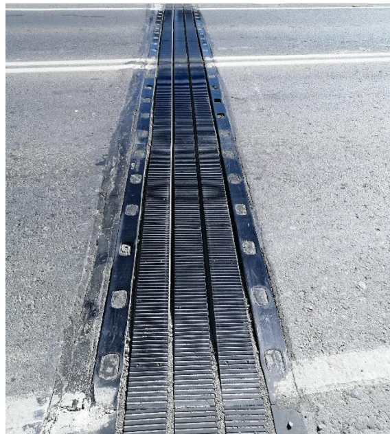
Figura 3.18: Cantonera elastomérica reforzada en puente Tres Esquinas.
