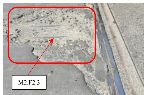
Figura 4.9: Ilustración de falla M2.F2.3. Fuente: Propia, puente 19 de junio, 2021.
