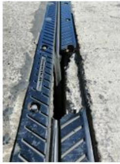
Figura 130 Desprendimiento de mortero de transición
