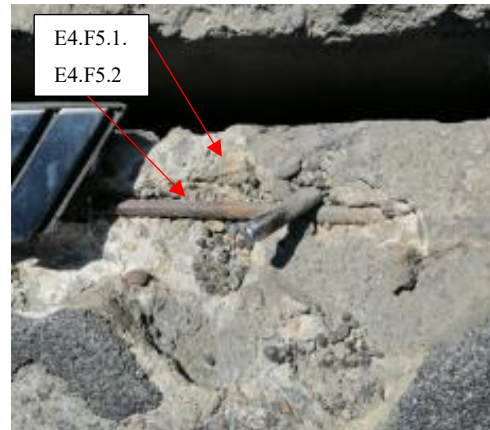
Figura 4.51: Ilustración de falla E4.F5.1 y E4.F5.2 Fuente: Propia, puente Marga Marga, 2021.
