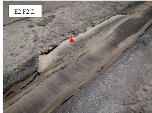
Figura 4.32: Ilustración de falla E2.F2.2. Fuente: Propia, puente 21 de mayo, 2021.
