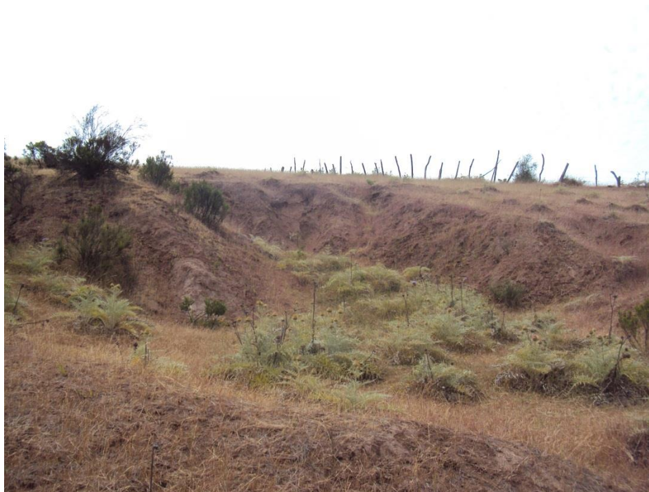
Figura 39. Vista general cárcava N°5.1 y 5.2.
