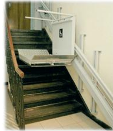
En los sectores donde el ascensor no alcanza a llegar que es principalmente a algunos sectores del Hostal, se utilizan Rampas mecánicas para la movilidad de los discapacitados
