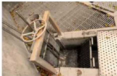
Figura 9: Rejilla de limpieza manual (CONAGUA, 2019)
