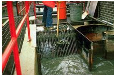
Figura 10: Rejilla de limpieza manual.
