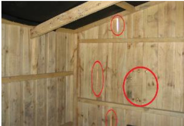
FIGURA 32: IDENTIFICACIÓN DE FILTRACIONES EN VIVIENDAS DE EMERGENCIA ( HTTPS://DOCPLAYER.ES/59801774-RESUMEN-PALABRAS-CLAVE-AISLAMIENTO-TERMICO-ALTERNATIVO-VIVIENDA-DE-EMERGENCIA-ECOLADRILLOS.HTML ).
