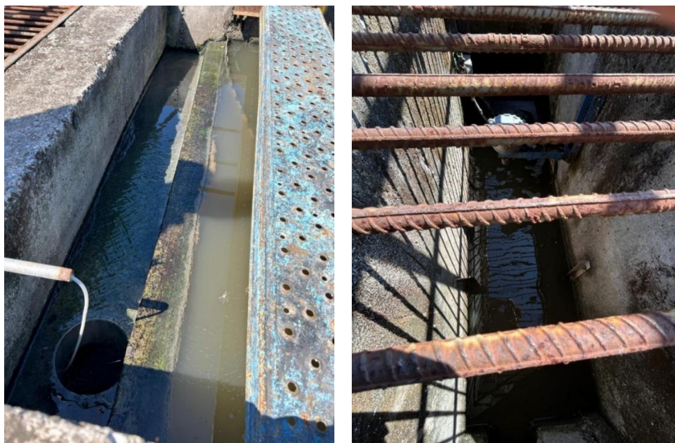
Imagen 9.9 – Sector de desinfección – cámara de cloración
