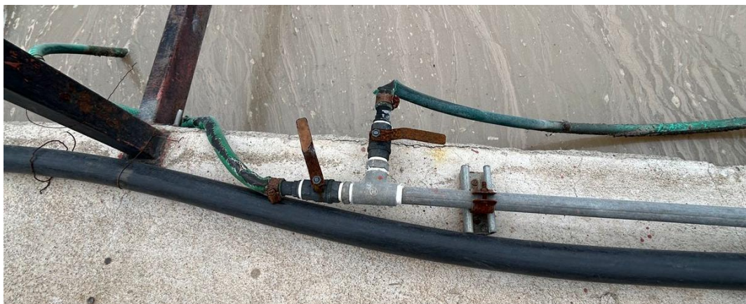
Imagen 6.19 – Mangueras dañadas por exposición prolongada del sol
