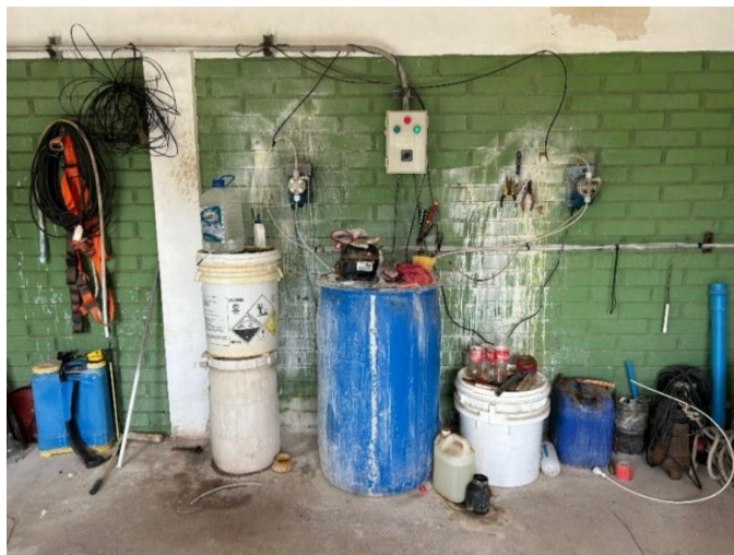
Imagen 5.12 – Sala de cloración
