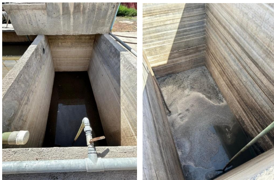
Imagen 5.9 – Tanques de lodo de retorno. Línea 1 (imagen izquierda). Línea 2 (imagen derecha)
