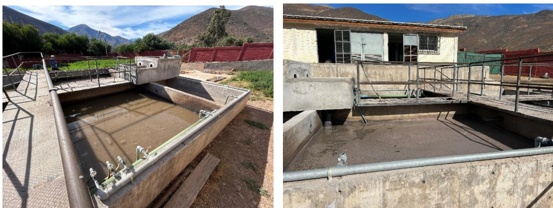
Imagen 5.7 – Tanques de aireación. Línea 1 (imagen izquierda). Línea 2 (imagen derecha)
