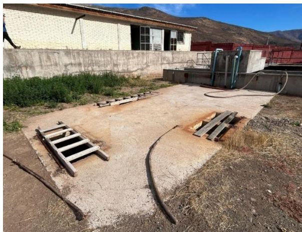
Imagen 5.15 – Accesos de sedimentador primario y estación elevadora
