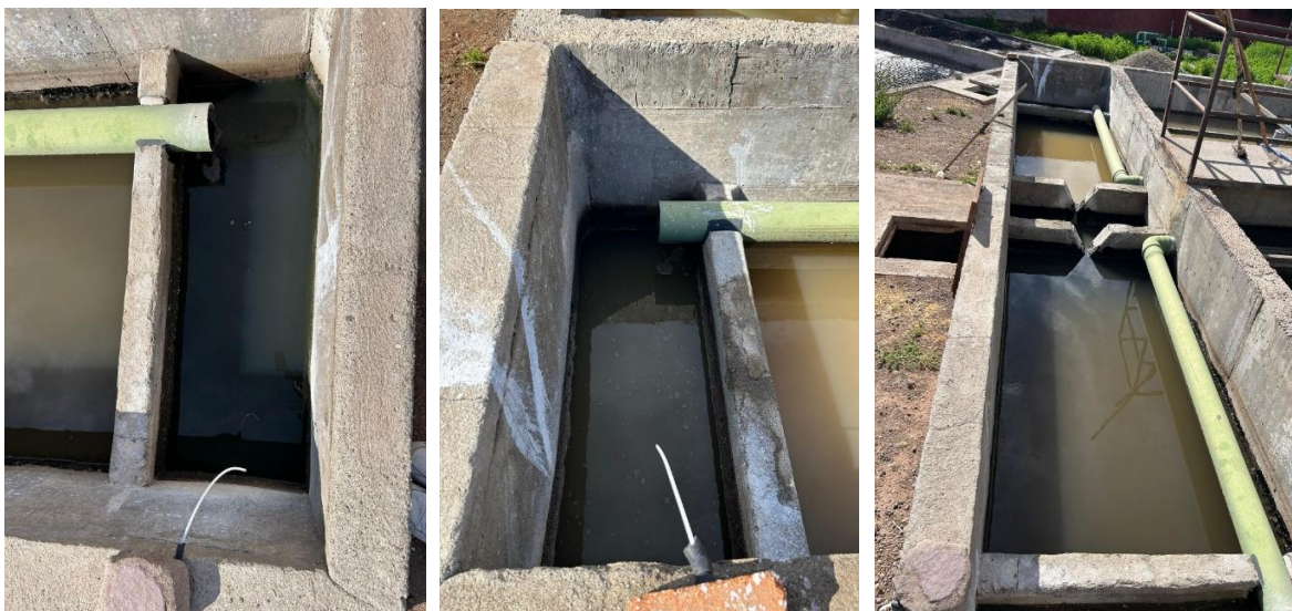
Imagen 5.10 – Sectores de cloración. Línea 1 (imagen izquierda). Línea 2 (imagen centro). Sector de cloración, incluyendo ambas líneas (imagen derecha)
