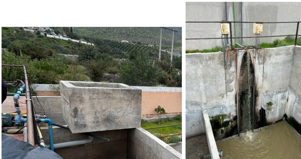
Imagen 6.9 – Cámara distribuidora de caudal (imagen izquierda). Excedente que retorna a sedimentador primario (imagen derecha)
