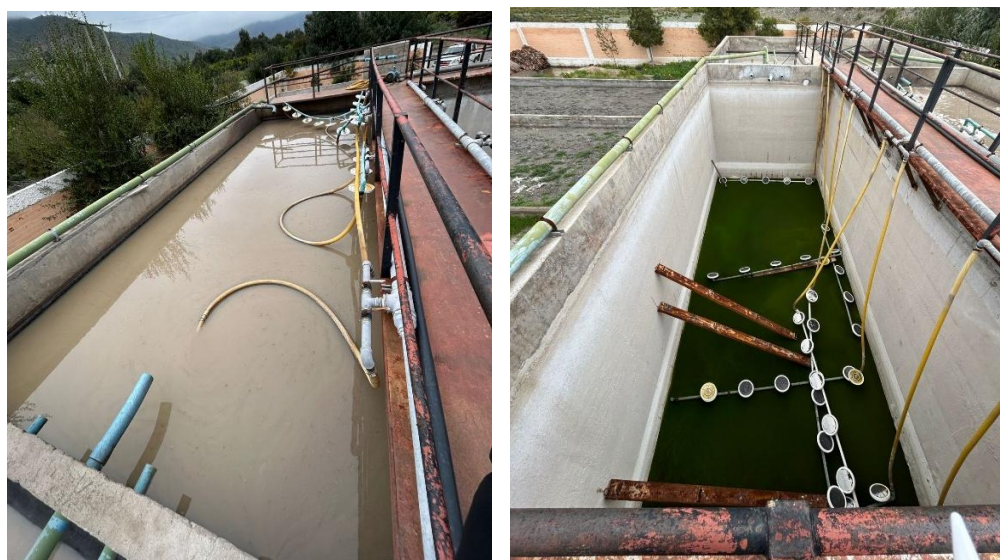
Imagen 6.10 – Tanque de Aireación. Línea 1 (imagen izquierda). Línea 2 fuera de servicio (imagen derecha)
