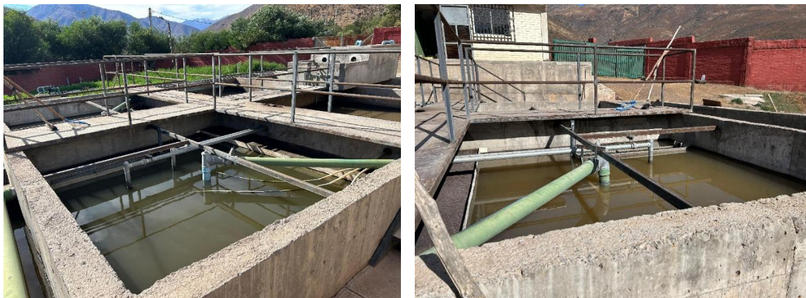
Imagen 5.8 – Sedimentadores secundarios. Línea 1 (imagen izquierda). Línea 2 (imagen derecha)
