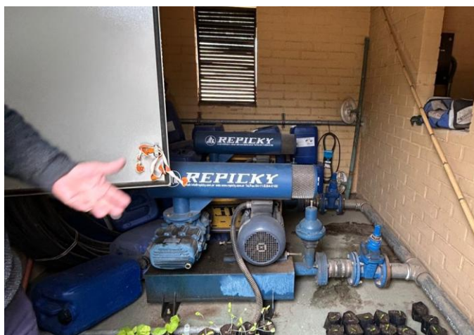
Imagen 6.16 – Sala de equipos, “Sopladores”
