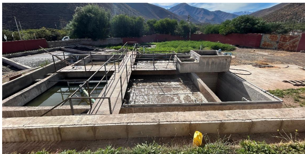
Imagen 3.6 – Sistema de lodos activados, aireación extendida. [Fotografía propia]
