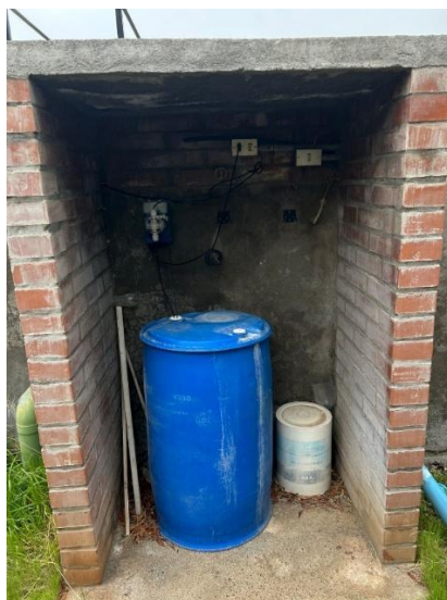
Imagen 6.15 – Sala de cloración
