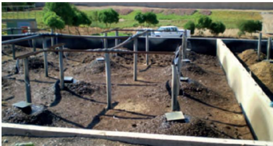
Imagen 3.11 – Lombrifiltro construido y en operación [4]
