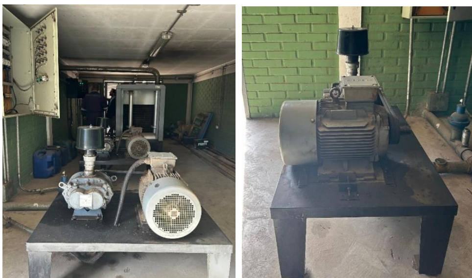
Imagen 5.13 – Sala de equipos (imagen izquierda). Soplador (imagen derecha)
