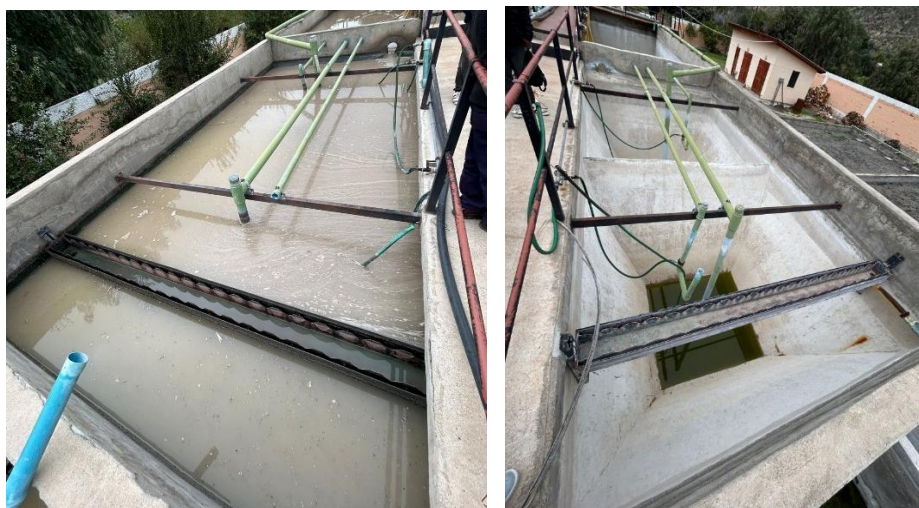
Imagen 6.11 – Sedimentador secundario. Línea 1 (imagen izquierda). Línea 2 fuera de servicio (imagen derecha)
