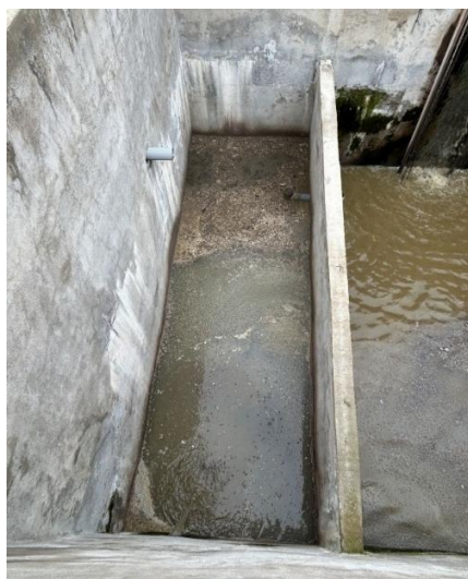
Imagen 6.7 – Estanque Receptor de aguas servidas o Desarenador
