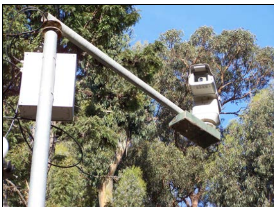
Imagen 3.186: Cámara de seguridad.
